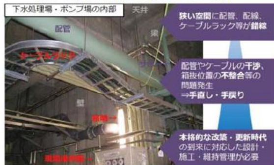
狭小空間に配管、配線されている例
