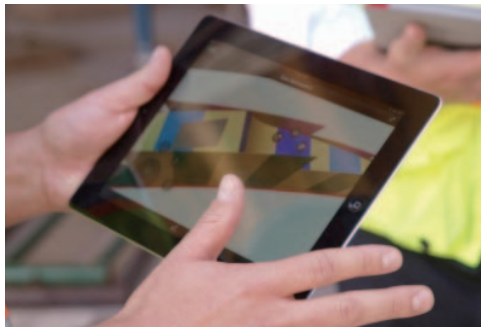
通称「バナナ」と呼ばれる屋根の基礎部分の型枠組みなどの施工管理には、iPadに入れた3Dモデルが役立った
