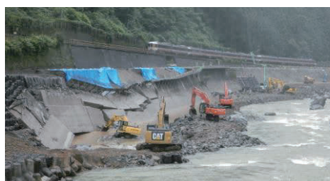
豪雨災害で被災した国道 41 号の復旧工事。約 2 週間後には JR 高山線が復旧した
