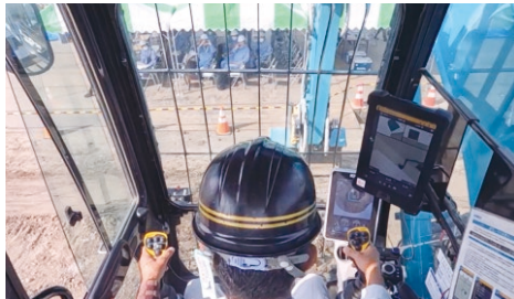
土工部ICT施工データ変換システム(eMS)の効果も実証済み
