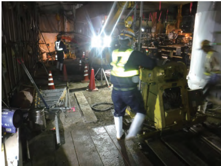
Point Layout によって墨出した位置からボーリングを行い、地盤改良用の薬液を注入する
